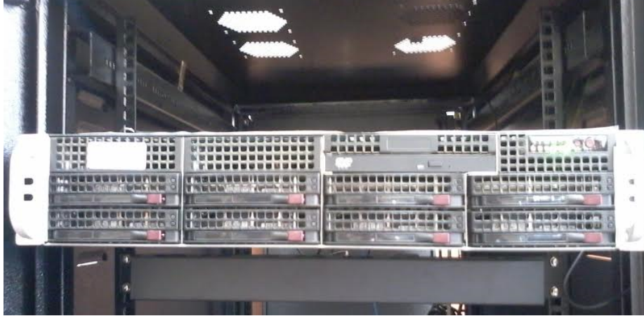
Figura 1 – Vista dianteira do SuperServer 6027 instalado no Campus de Florianópolis do IFSC.
